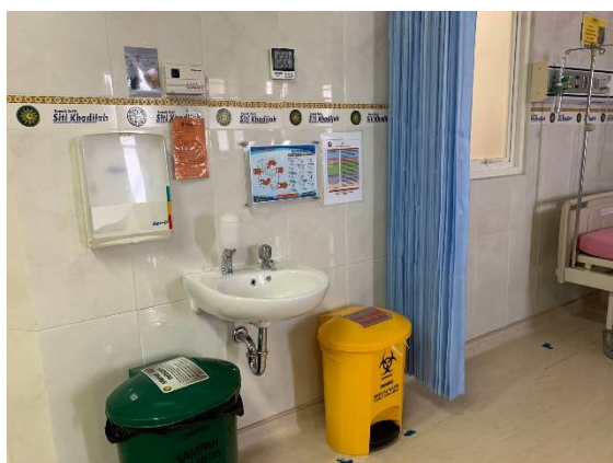
加護病房無菌洗手設備
