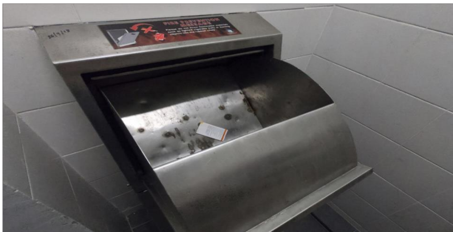
圖 40、達士嶺組屋各樓層廢棄物共同管道
