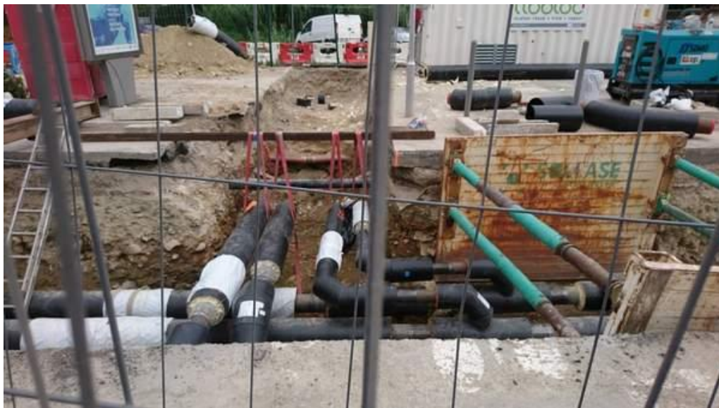
圖 22 Nice Méridia 地熱工程的地下冷暖氣管
