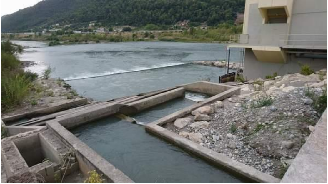
圖 29 瓦河的第 4 攔河堰的魚梯
