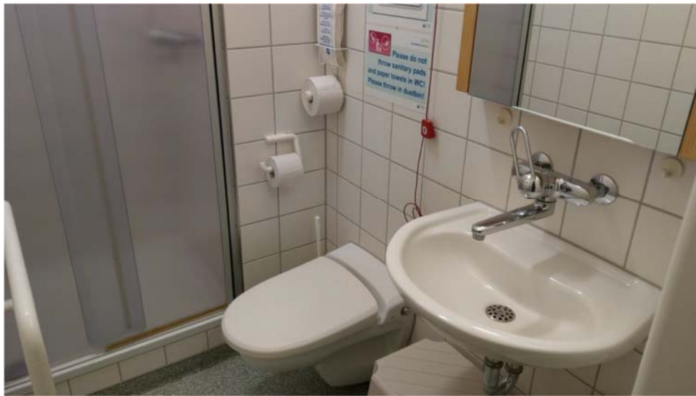
圖九、病房的衛浴設施，排水系統單獨集中排放水槽。
