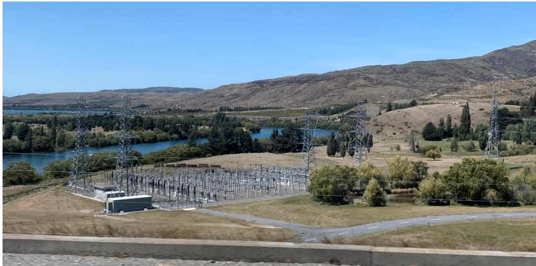
圖30、阿維莫爾水力發電站(2)
