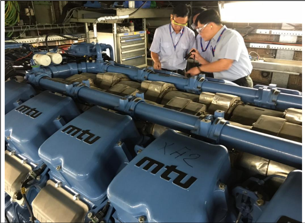
主機全負載時檢查是否有洩漏狀況
