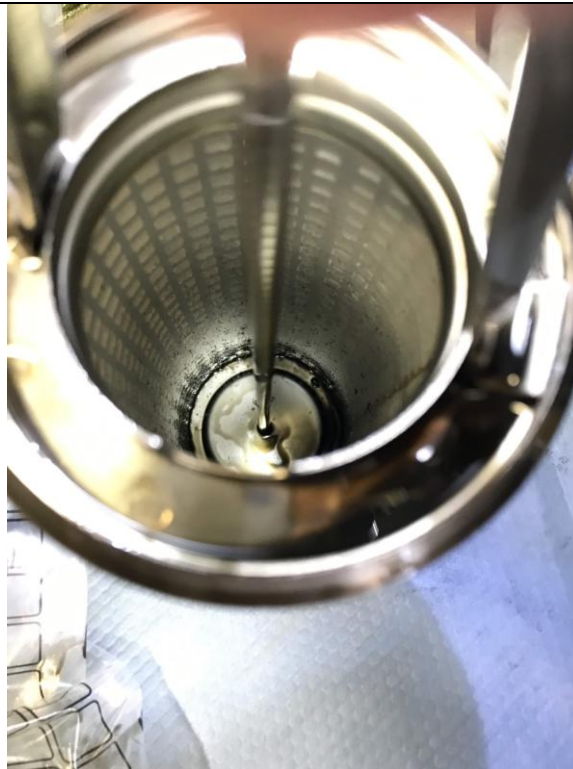
檢查滑油濾芯，以確定機件無異常磨耗情形
