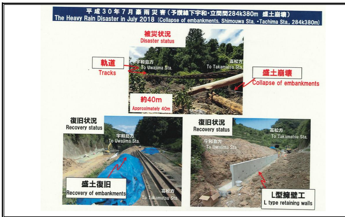
圖 3-34 予讚線下宇和立間間路堤災害情況
