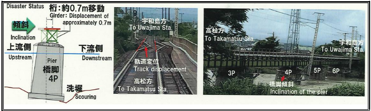
圖 3-21(a) 予讚線財田川橋 P4 橋墩基礎遭淘空
