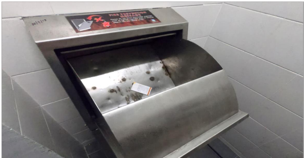
圖 43 達士嶺組屋各樓層廢棄物共同管道
