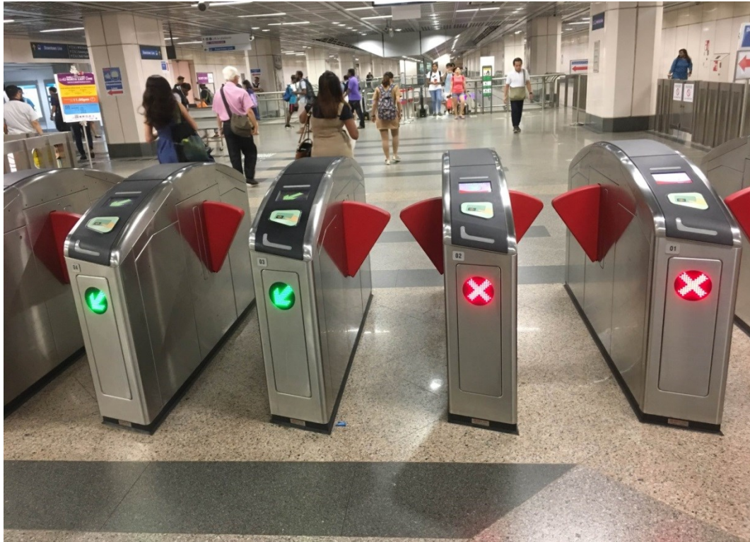
圖 34 捷運閘門系統
