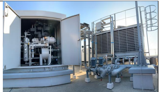
環保冷媒冷凍機組置頂樓，預防海嘯
