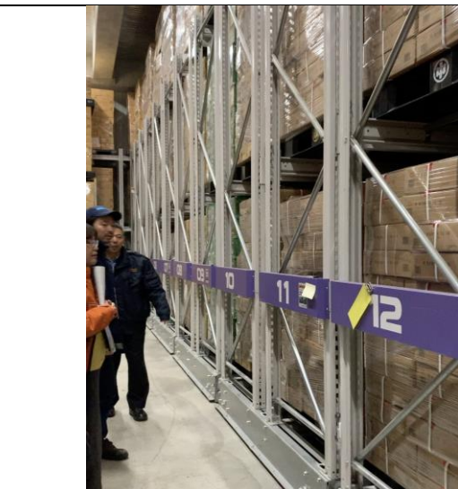
-25°C 冷凍庫設有移動貨架節省通道空間
