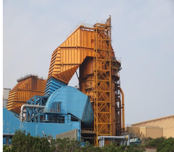
脫硫設備-吸收塔出口煙道
