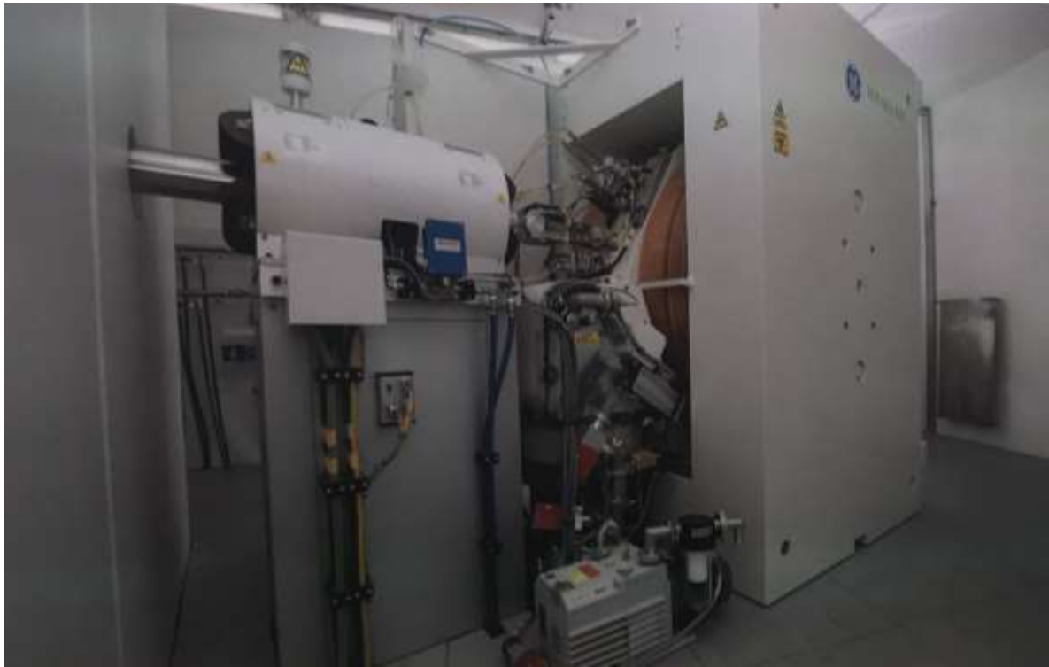
圖 114、巴特貝爾卡中央醫院核醫藥局的迴旋加速器。核醫藥局為獨立於醫院本館的一棟獨立建築，其迴旋加速器機型為 GE PETtrace 800 cyclotron。(圖片摘錄自巴特貝爾卡中央醫院專訪影片)
