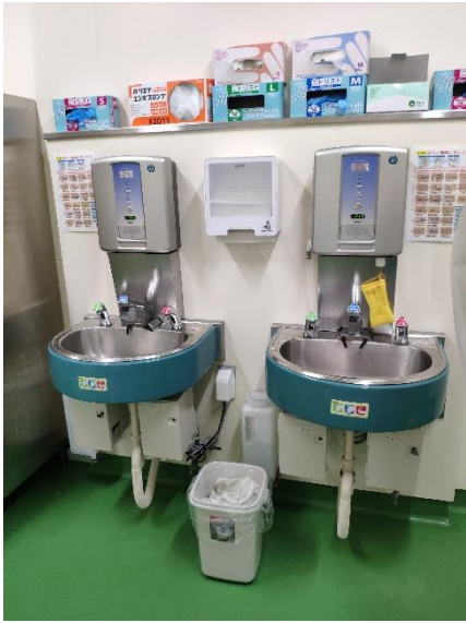
圖 5-1 衛生準備室-電解水洗手設備
