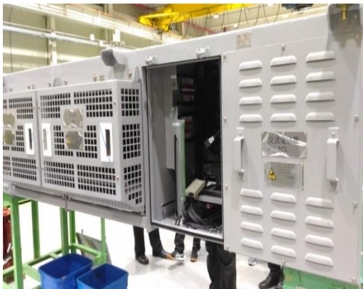
圖 3-39 本路 SIV 設備檢視(外側)
