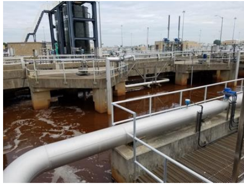
(a) 廠區入口處及硝化/脫硝反應槽
