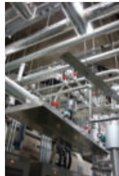
地下室廢水處理設備
