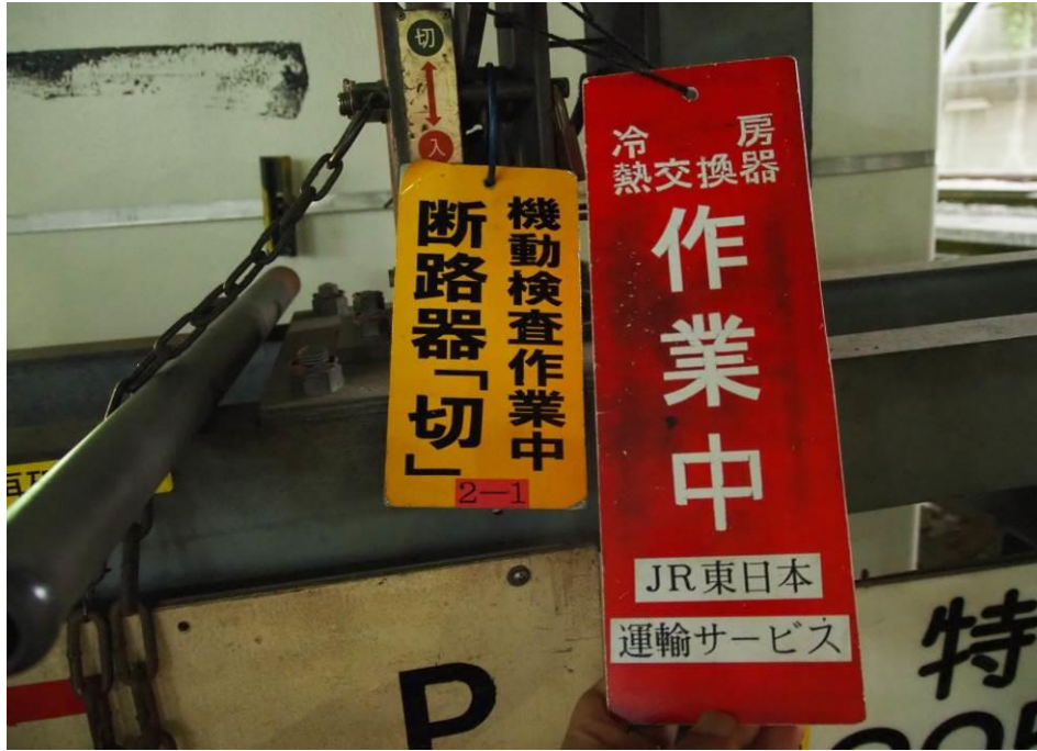
圖 29 電力開關斷電後於開關掛上牌子
