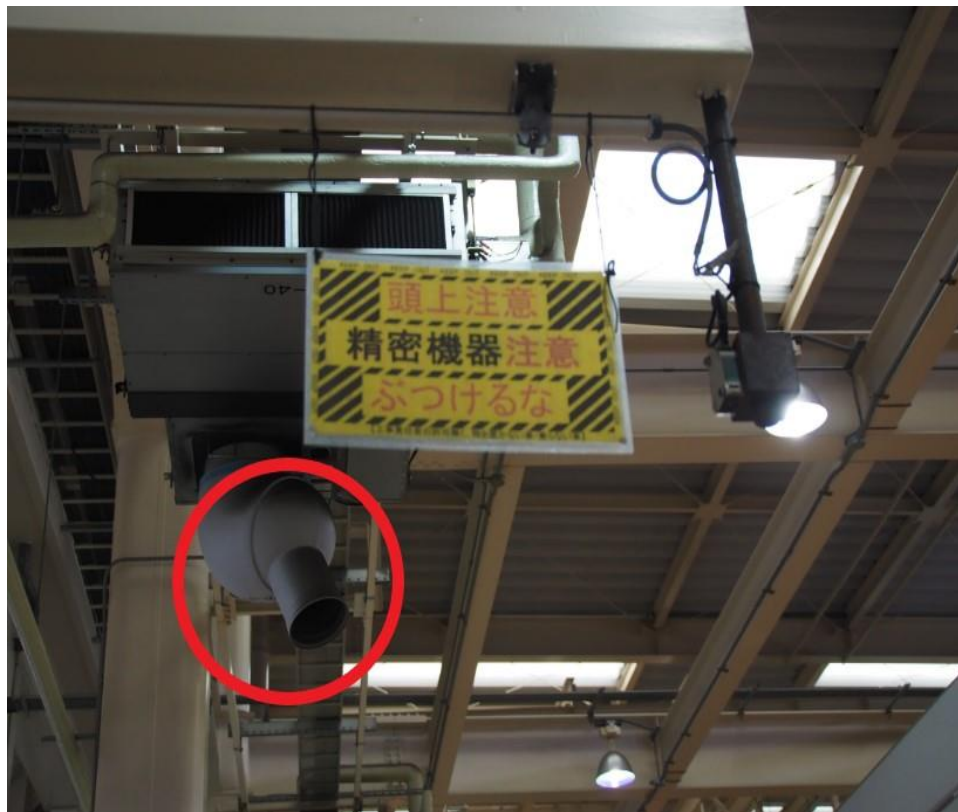
圖 36 舒適的維修廠房 - 提供溫度適中的空調
