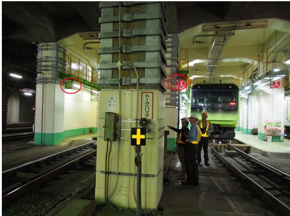
圖 30 軌道上所顯示紅色燈號為有電，綠色為已斷電
