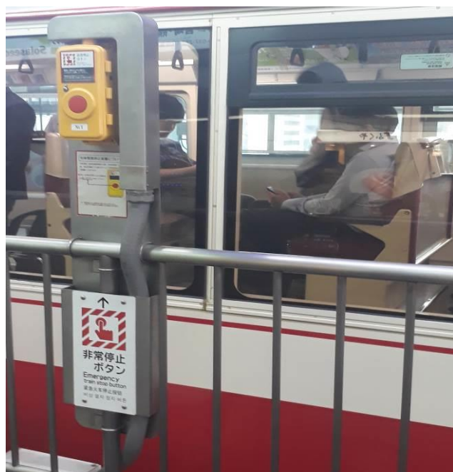
圖 3 Tokyo Monorail - 浜松町站月台上列車緊急停止按鈕
