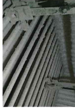
■圧力波クリーニング装置運転時
