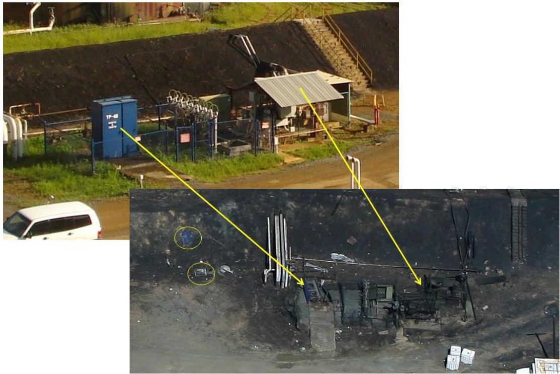
圖 17 第 2 次爆炸引火點引火設備外觀
