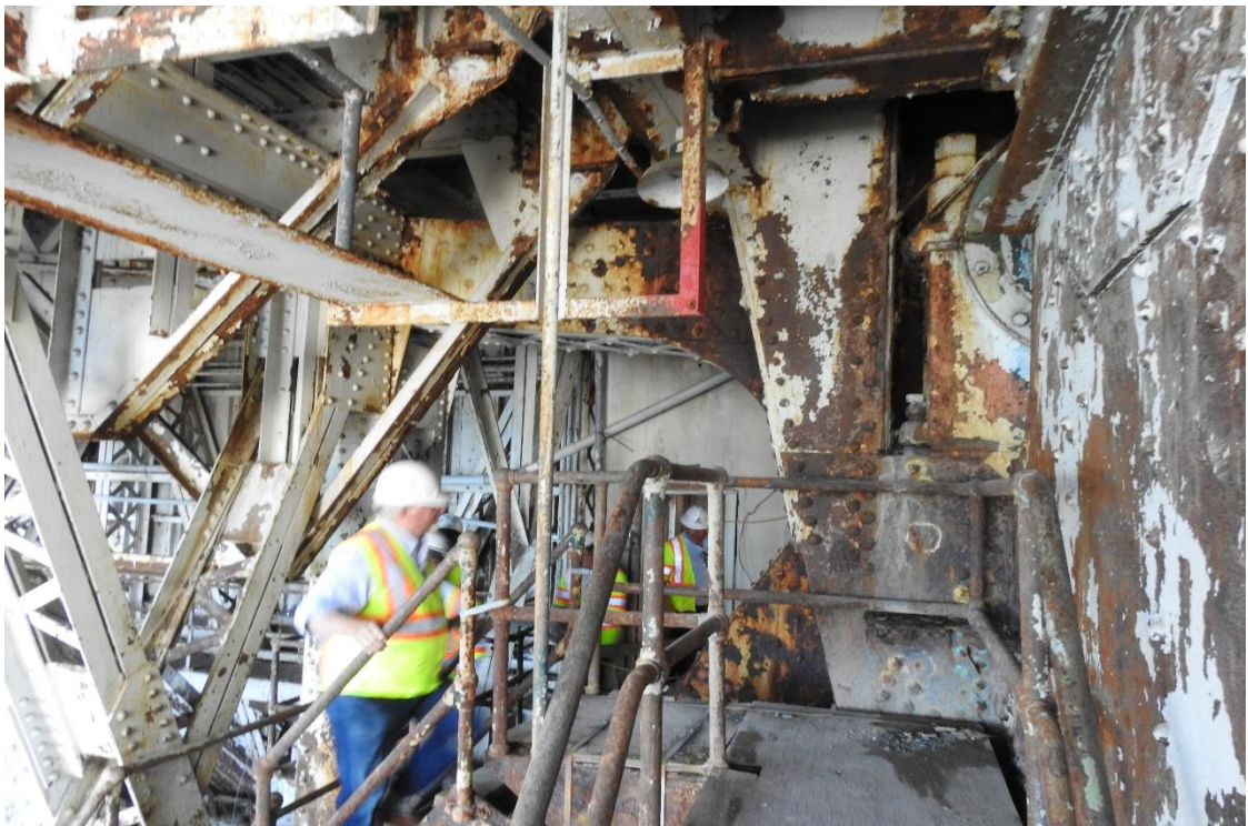
圖 3- 27 Arlington Memorial Bridge 活動開合跨度鏽蝕情形
