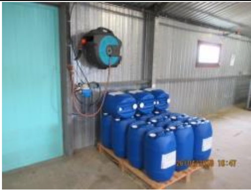
肉豬試驗舍除臭設備
