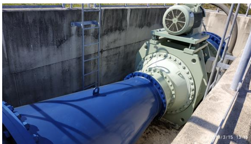
圖 17、森ヶ崎水再生中心小水力發電機組實況
