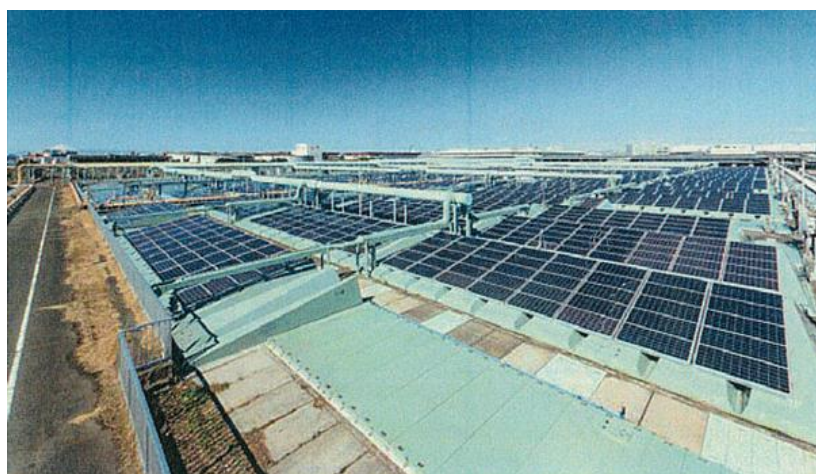
圖 18、森ヶ崎水再生中心反應槽防護蓋上設置太陽能版
