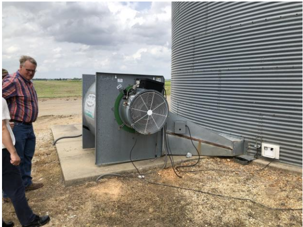
稻穀筒倉送風設備
