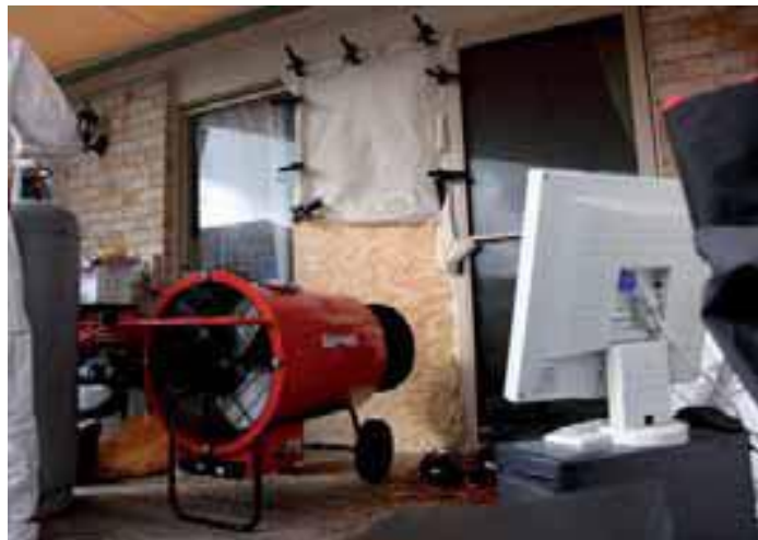
圖三、高溫乾衣機設備
