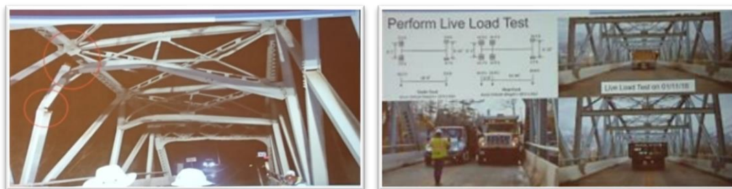
圖 5 馬里蘭州歷史公園桁架橋撞擊損壞及修復後全載重試驗
