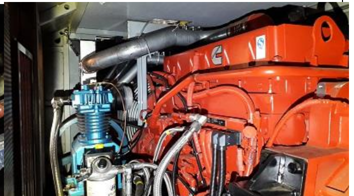
RC-11 引擎室(引擎含空壓機)
