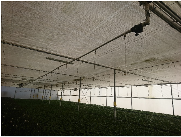
設施全區噴灌
