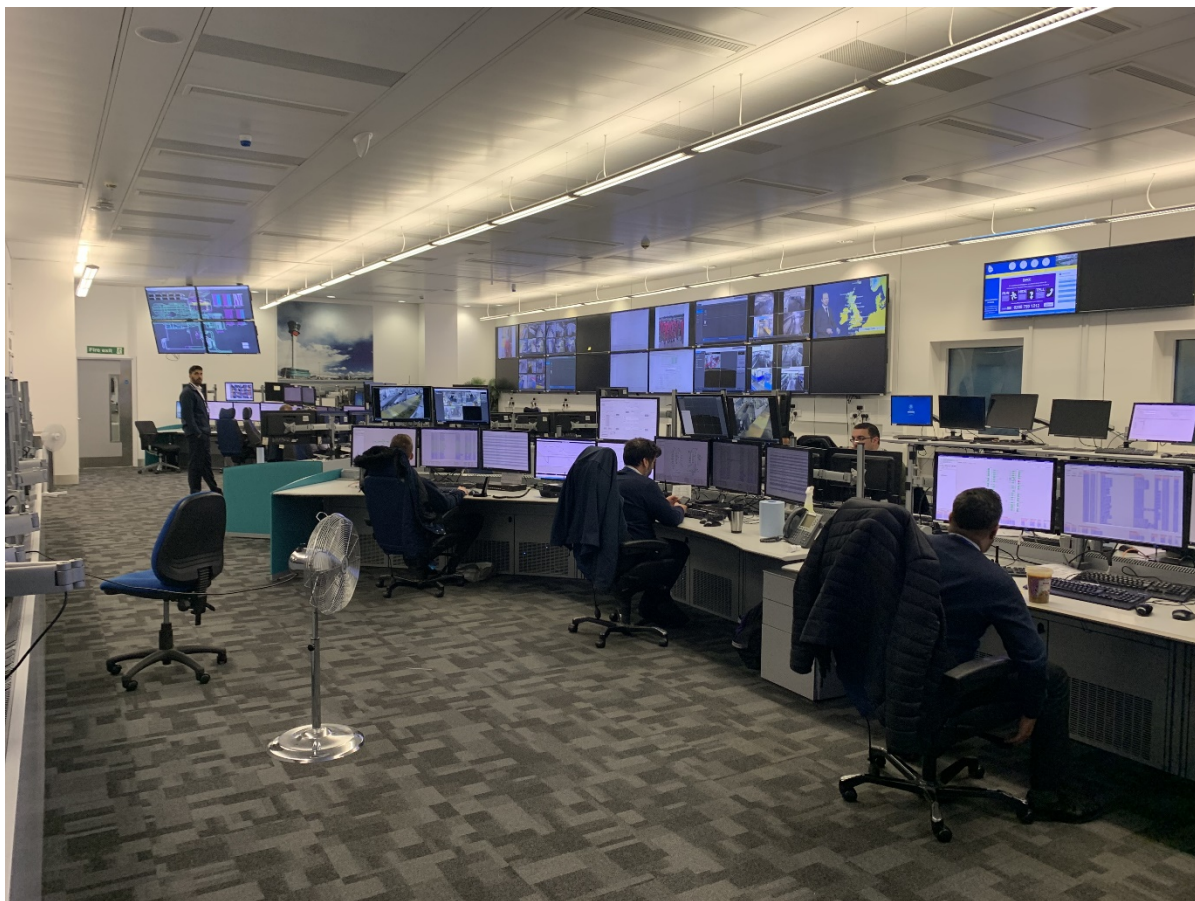
圖 33- 希斯洛機場全機場行李處理系統控制中心
