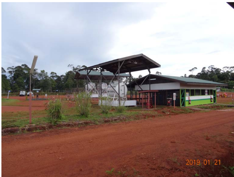
Bumbun 營區柴油發電機及燃料槽
