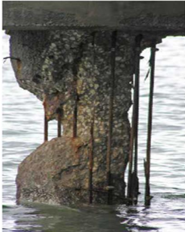
圖 2-20 海洋環境下鋼筋混凝土樁腐蝕情形
