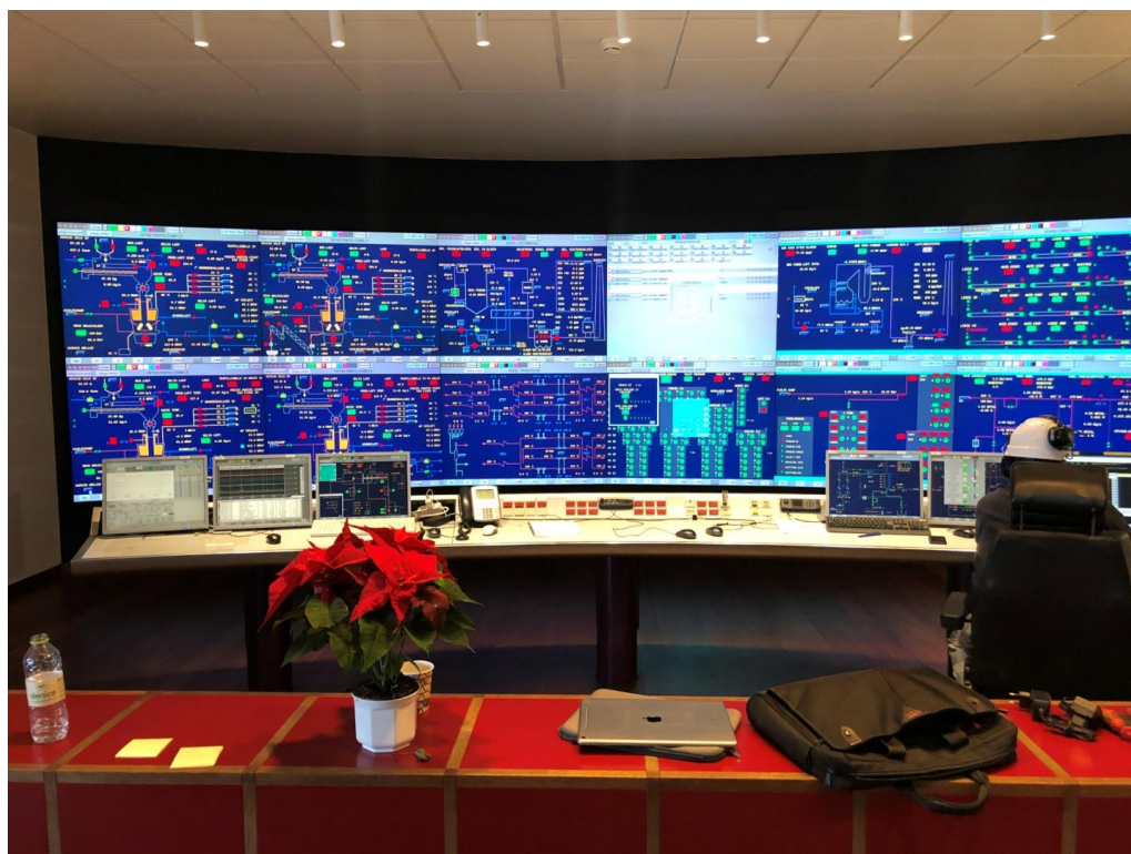
圖 25Avedøre 發電廠控制室
