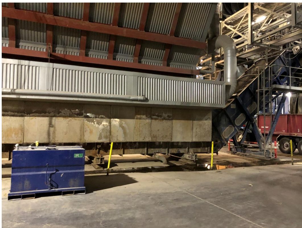
圖 26Avedore 發電廠底灰收集區
