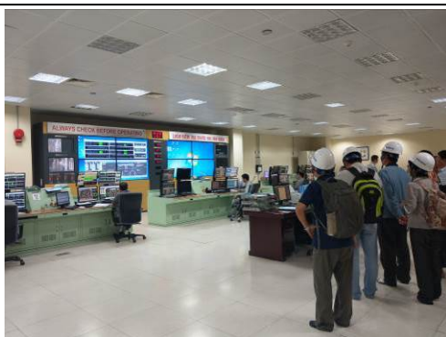
勘查電廠廠內燃煤機具控制室
