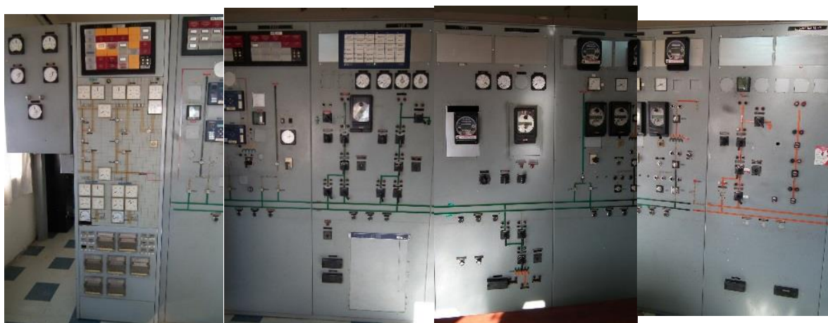
圖 19 SuYaPa 超高壓變電所控制室盤面(1/2)
