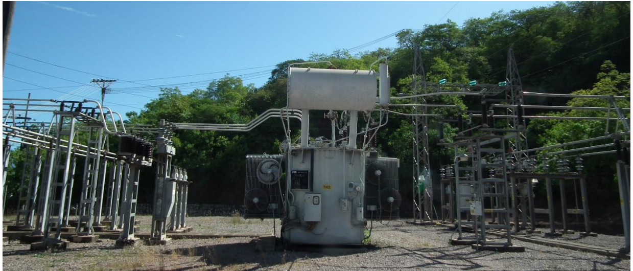
圖 29 T422 配電變壓器及左側之 22T22 斷路器
