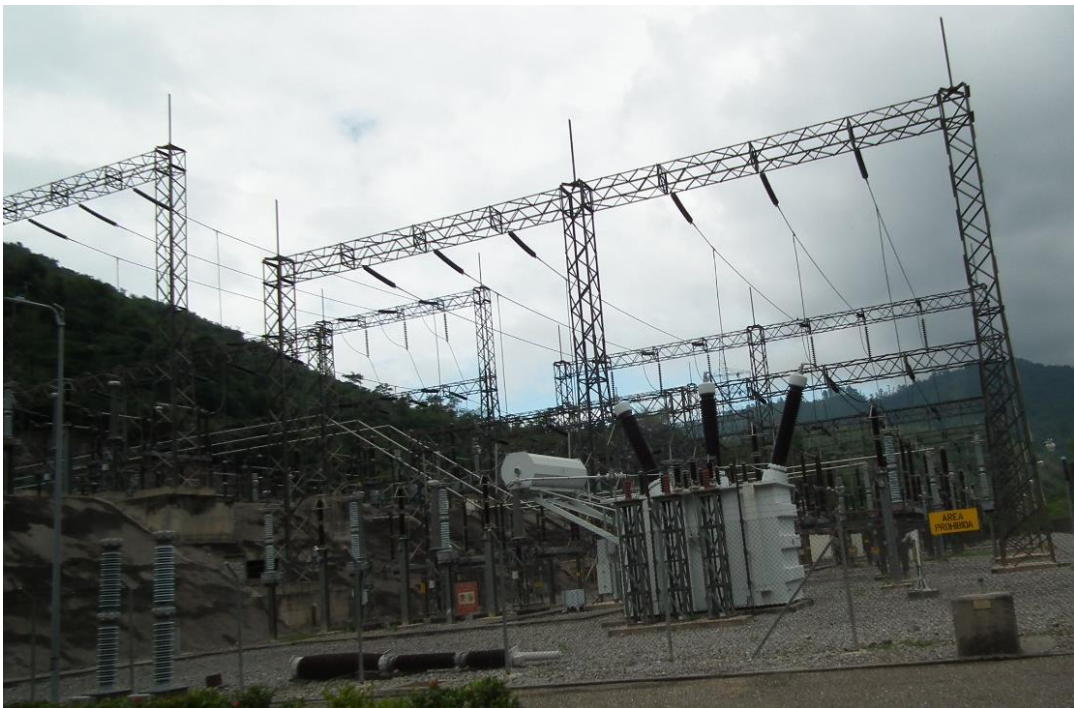
圖 46 EL CAJON (CJN)發電廠開關場
