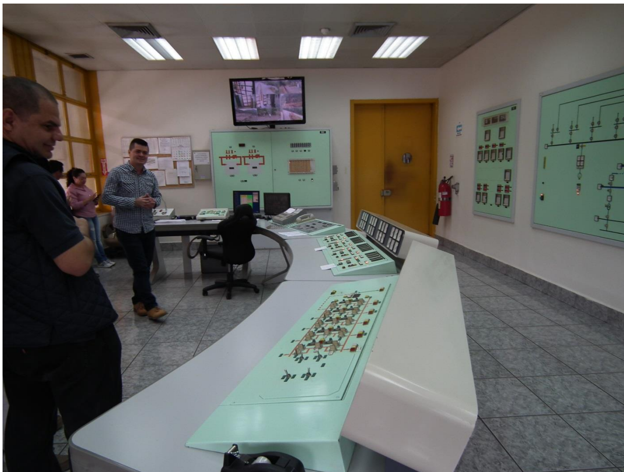
圖 47 EL CAJON (CJN)電廠控制室
