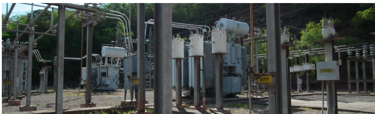
圖 24 所內二台變壓器實體中間未間隔以防火牆
