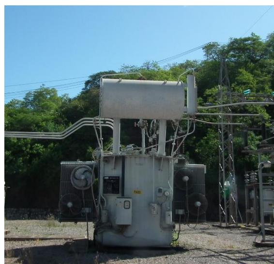
T422 配電變壓器
