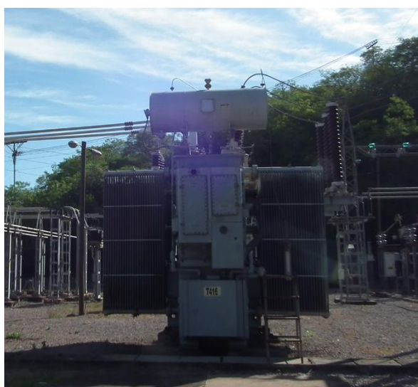
T416 配電變壓器
