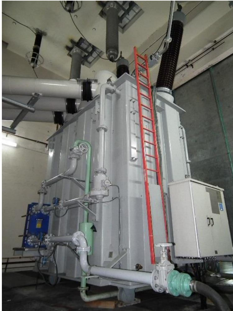
圖 45 EL CAJON (CJN)發電廠發電機升壓變壓器
