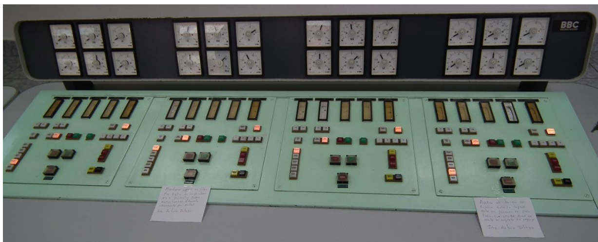
圖 51 EL CAJON (CJN)電廠發電機運轉控制及資訊盤面
