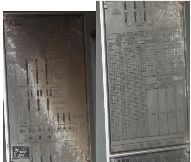
T524 變壓器銘牌
