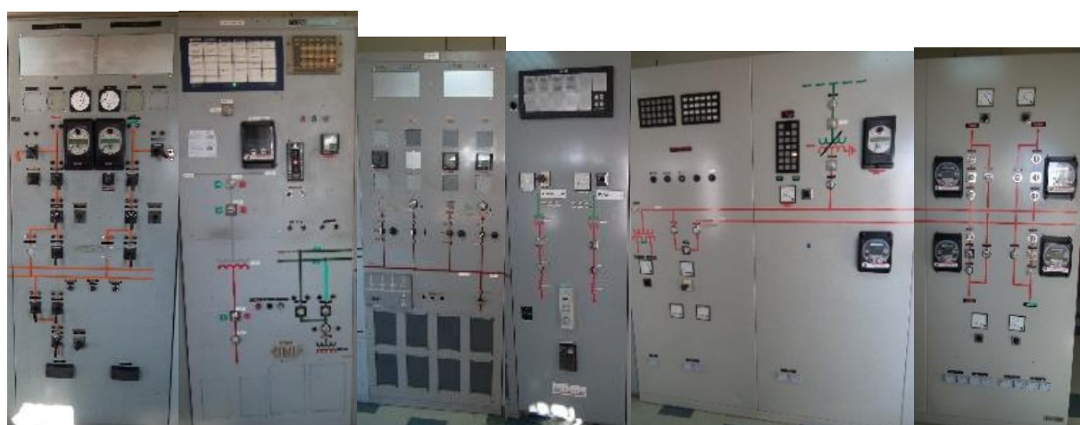
圖 20 SuYaPa 超高壓變電所控制室盤面(2/2)
