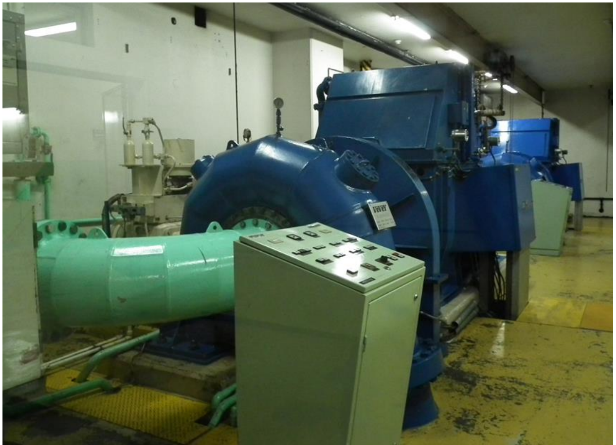
圖 49 廠內用電輔助發電機
