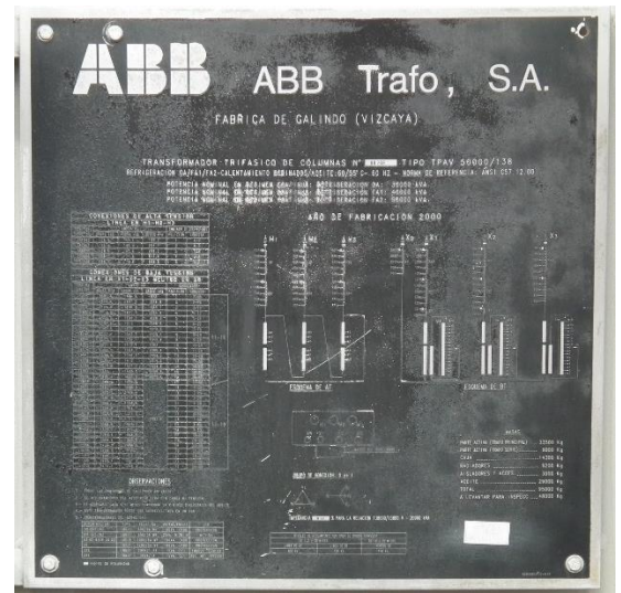
T517 變壓器銘牌
