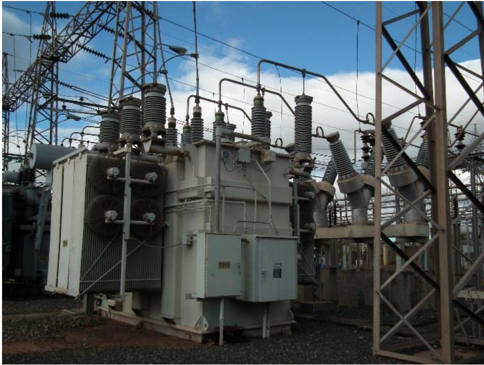
圖 10 T510 500MVA 138/69kV 自耦變壓器及其低壓側之斷路器
