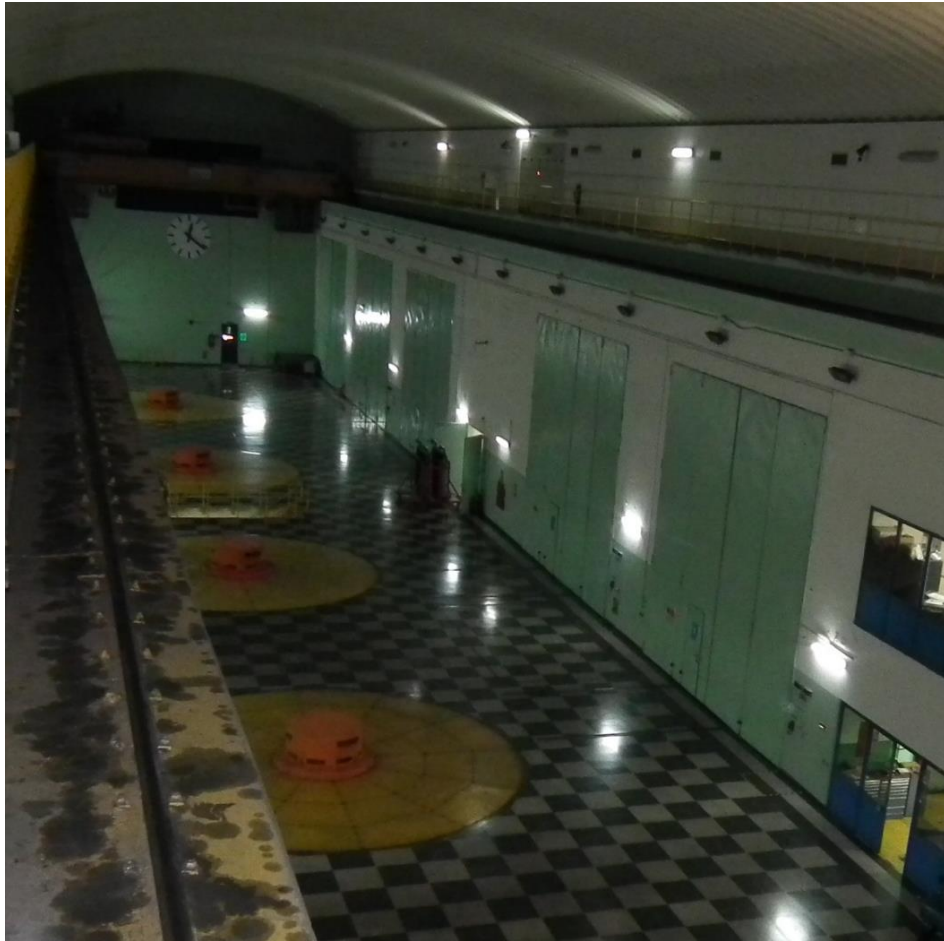
圖 43 EL CAJON (CJN)發電機室之 4 部法蘭西式發電機
