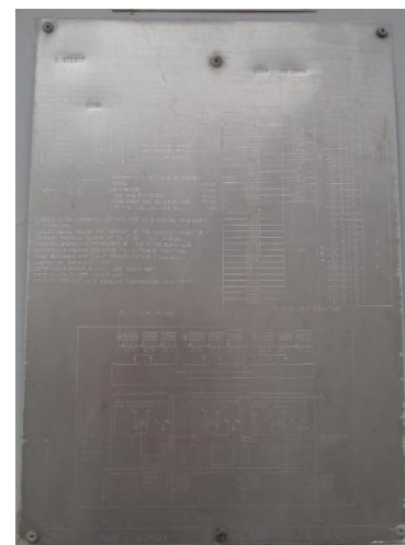
T608 變壓器銘牌
