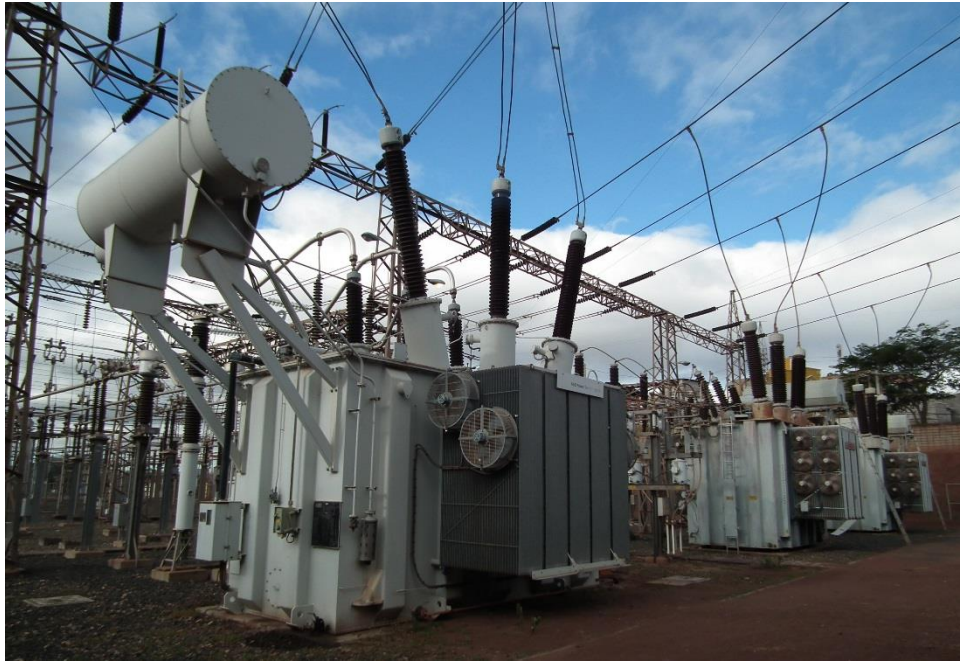
圖 7 由近而遠之 T611、T613 及 T612 之 230/138kV 變壓器
