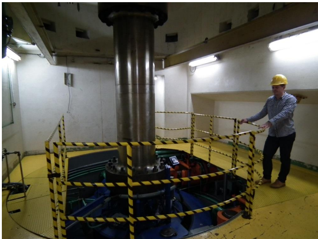
圖 44 EL CAJON (CJN)發電機室下方之發電機轉軸
