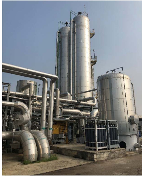
圖 22 儲熱水槽及加壓泵
