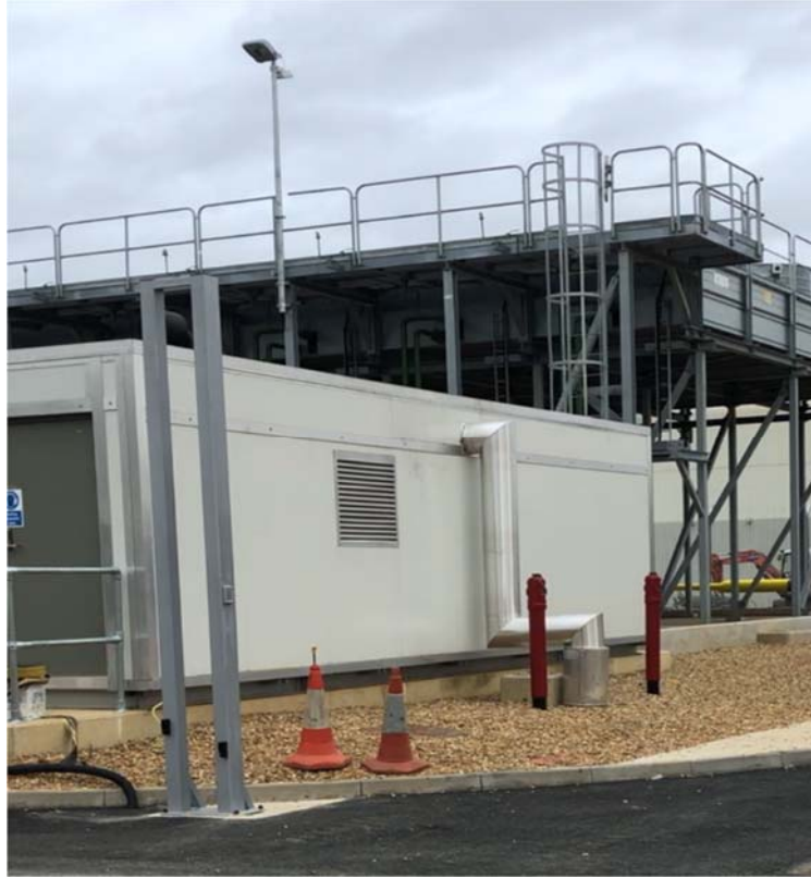
圖 30 散熱器及緊急柴油發電機
