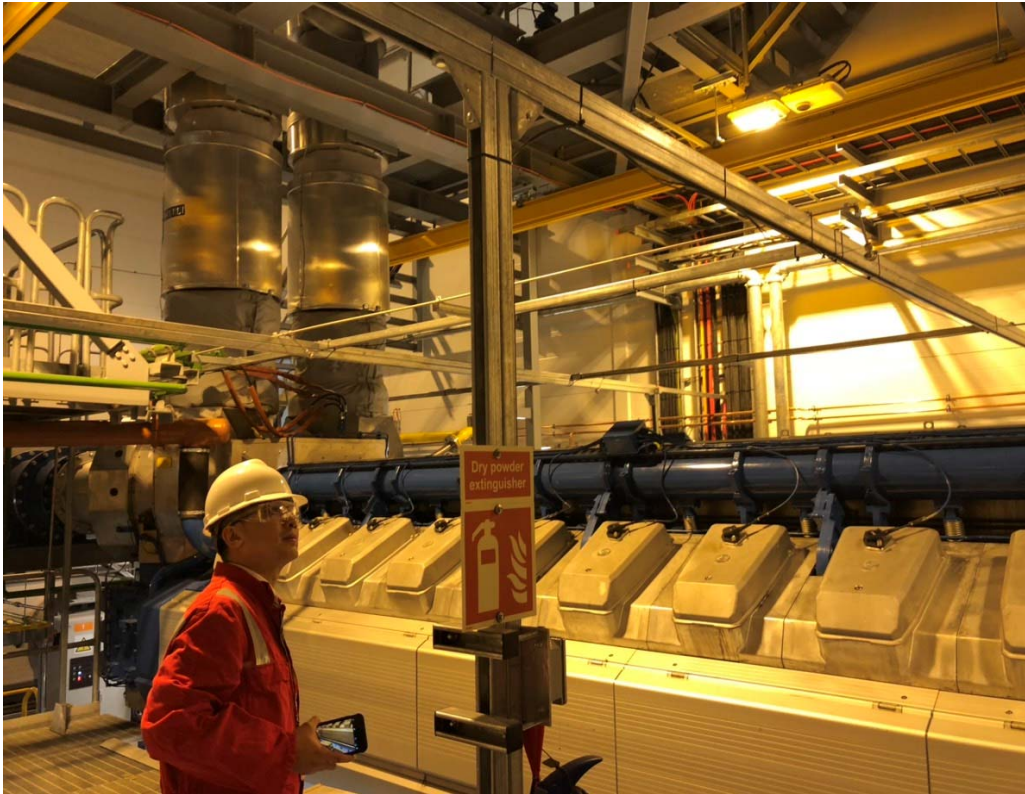
圖 28 開放式電纜線槽
