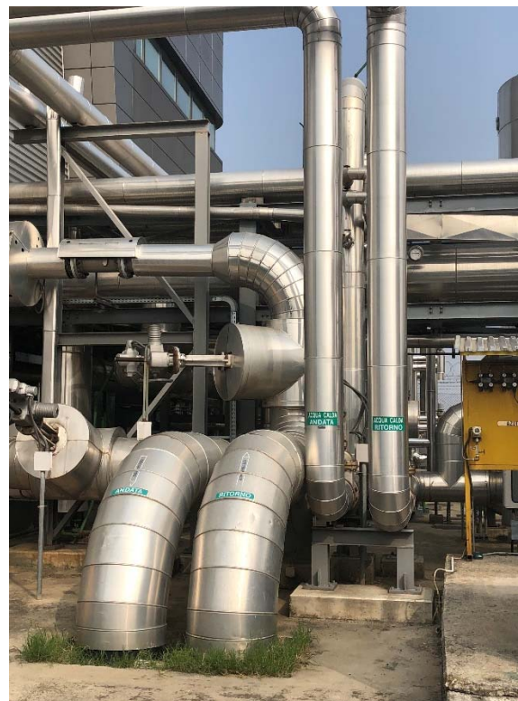
圖 24 儲熱水管路(一進一出)
