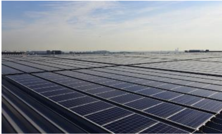
圖 10：TRC 新 B 棟頂樓之太陽能發電板
