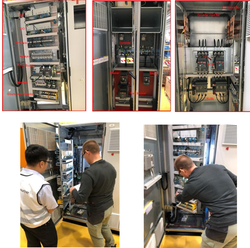
圖 4-4 設備內外檢查作業 表 4-1 D-AVR 設備基本名牌資料
