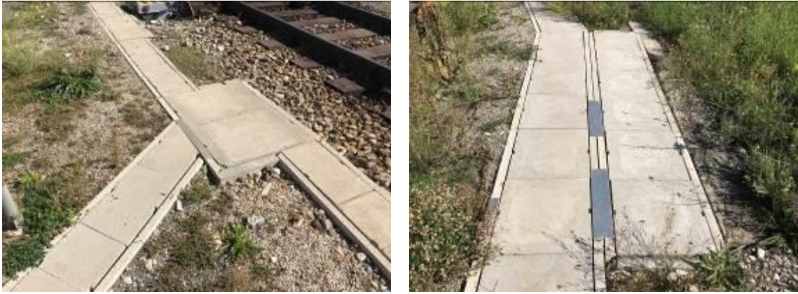
圖 5-2 沿線電纜槽施工品質良好
