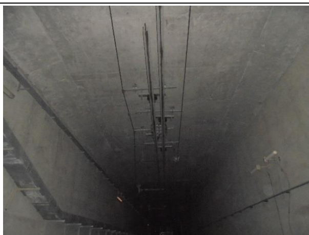
隧道內電車線採導電軌型式
