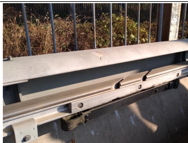
第三軌接觸面在上，上方設置防雨蓋
