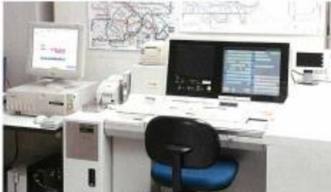
自動化された機器類に対応した係員教育(駅務機器室)
