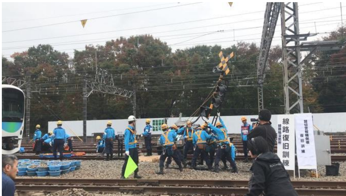
圖 25 電氣部搶修平交道號誌機
