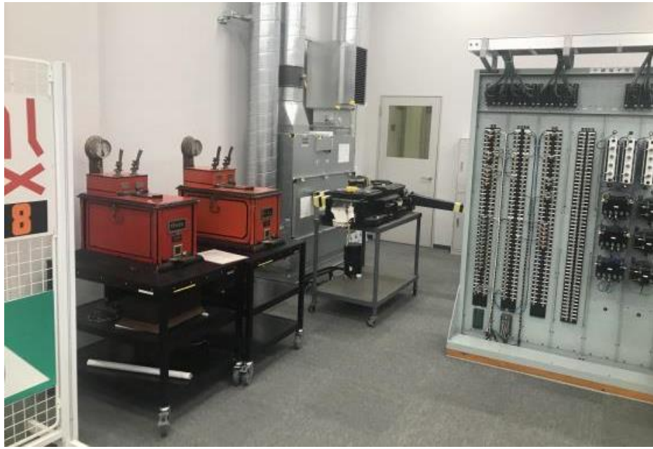
圖 45 實習教室內電氣號誌設備實物展示
