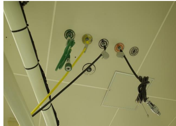
各種管線以不同顏色設置於天花板，以利辨識，該中心人員表示，未來新設計的管線出口將設計至落地活動櫃中，以更方便使用
