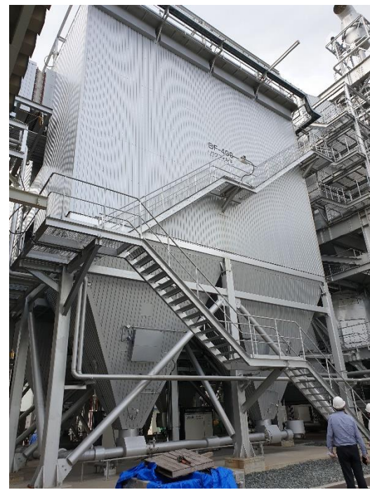
袋濾式集塵設施
