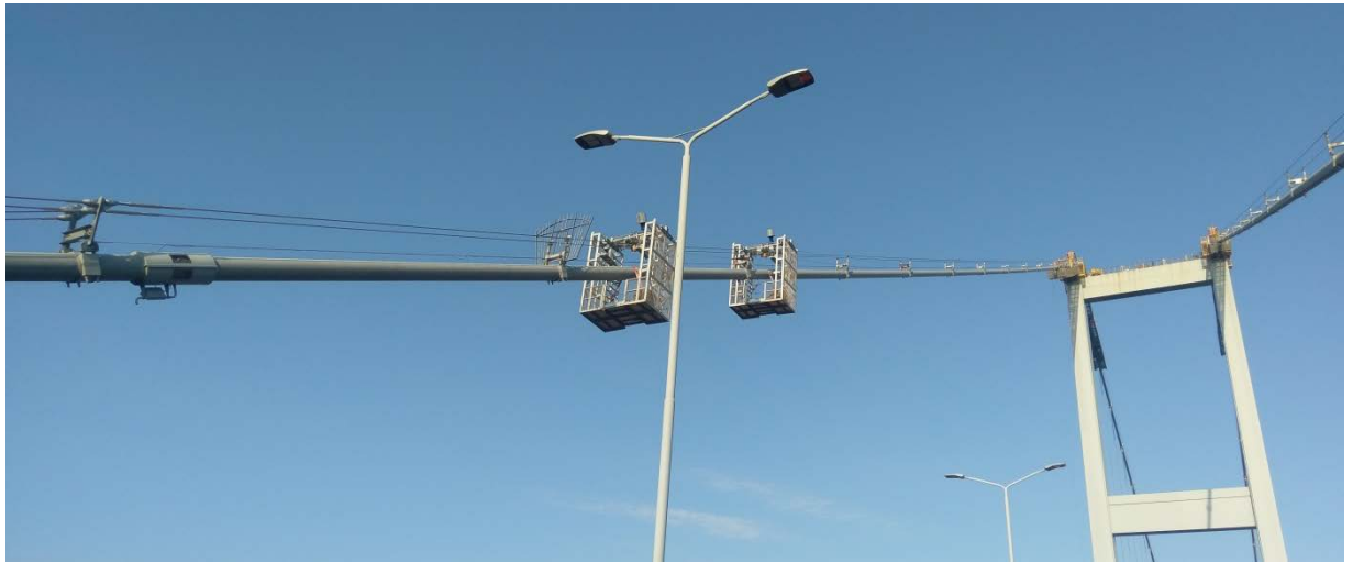
圖 3-1-2-4 第一大橋主纜檢修設施及阻絕柵欄
