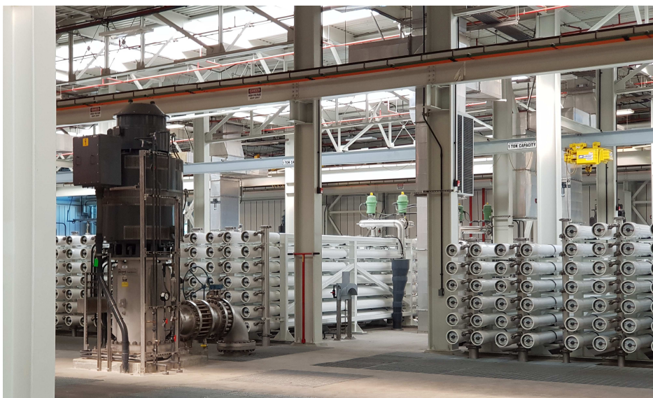
圖 10 逆滲透廠區圖示 (左方為加壓設備)
