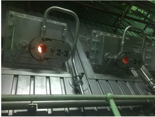
鍋爐的窺火孔
