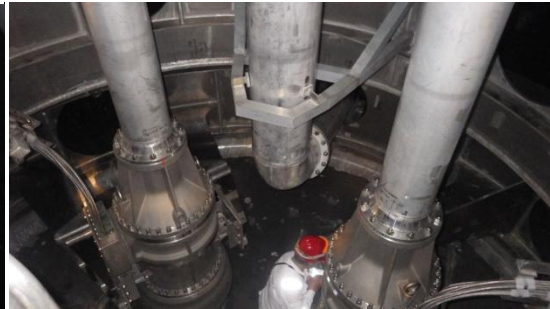
船員檢查貨油泵緊定
