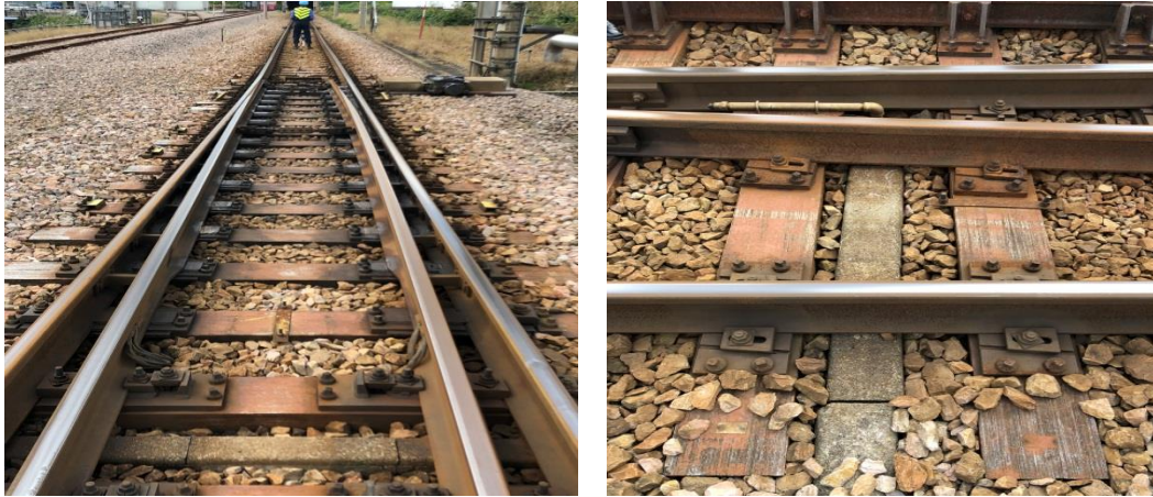
圖 52 道岔尖軌及道岔合成枕
