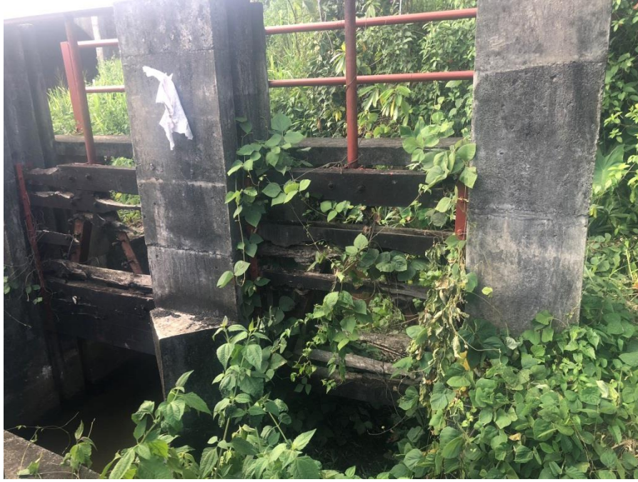
圖21. 當地水閘門已破舊不堪，且為人工操作，不易啟閉
