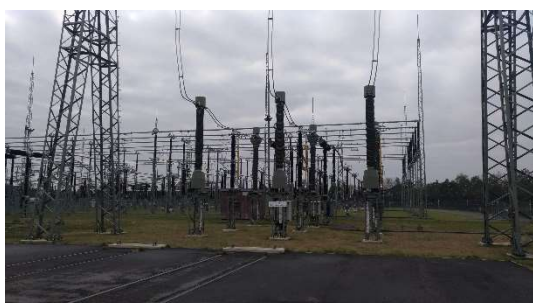
圖八：Dolwin 3 HVDC 變流站外觀
