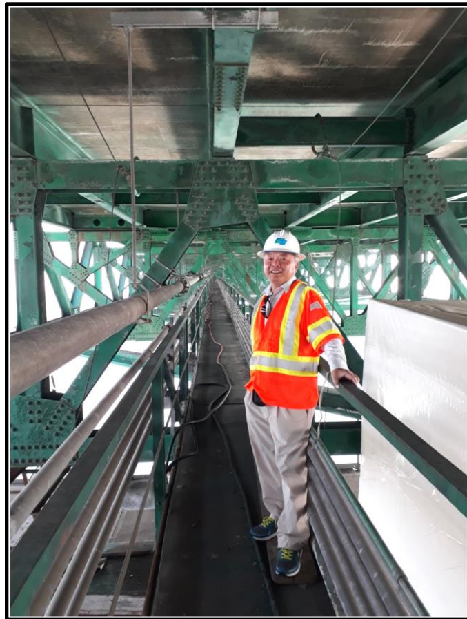
在設計階段即考量巡檢人員的檢修便道(貓道)
