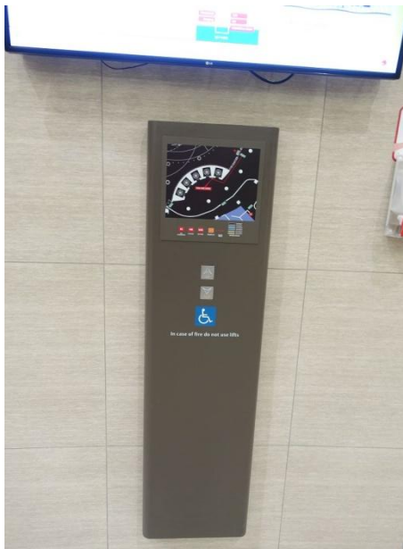
邱德拔醫院電梯按鈕多功能
