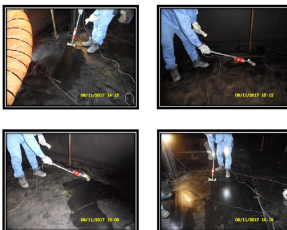
漏塗點檢測漆膜內的裂口、針孔和其它缺陷
