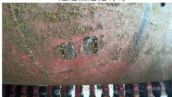
左舷海底門幾乎被海生物堵滿
